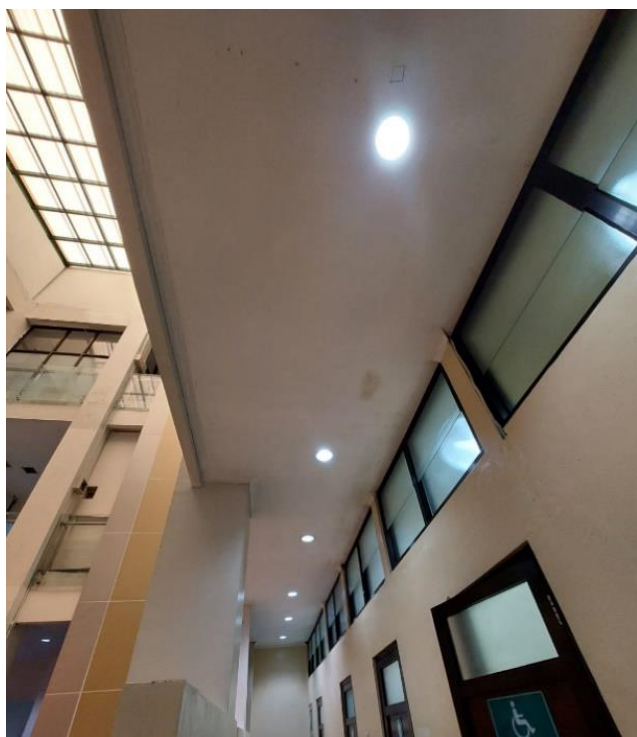
Lampu di Area Toilet Khusus Disabilitas di Wijaya Kusuma Lantai 1
